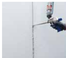
断熱材の隙間に
